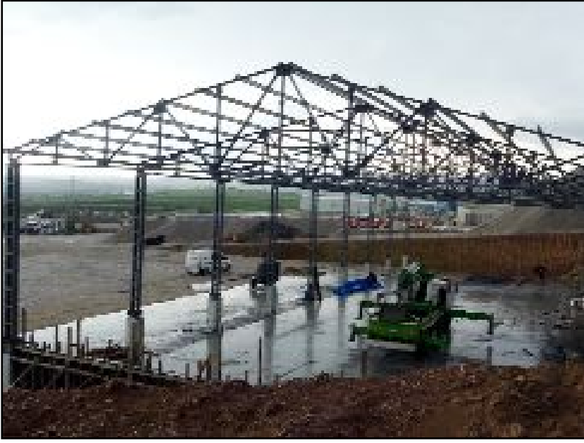
Fen İşleri Müdürlüğü Asfalt Şantiyesi Taş Ocağı ve Yol Bakım Amirliği Kampüsü'nde çelik çatı yapımı işinde çalışan Furkan Ahmet Akgül, çatı malzemesi serdiği esnada 9 metre yüksekten beton zemine düşerek ağır yaralandı.
