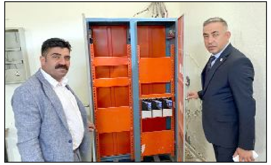
Tahtasız, okulun kapıları, pencereleri, kalorifer petekleri, elektrik kabloları ve işe yarar tüm eşyalarının hırsızlar tarafından çalındığını dile getirdi.
