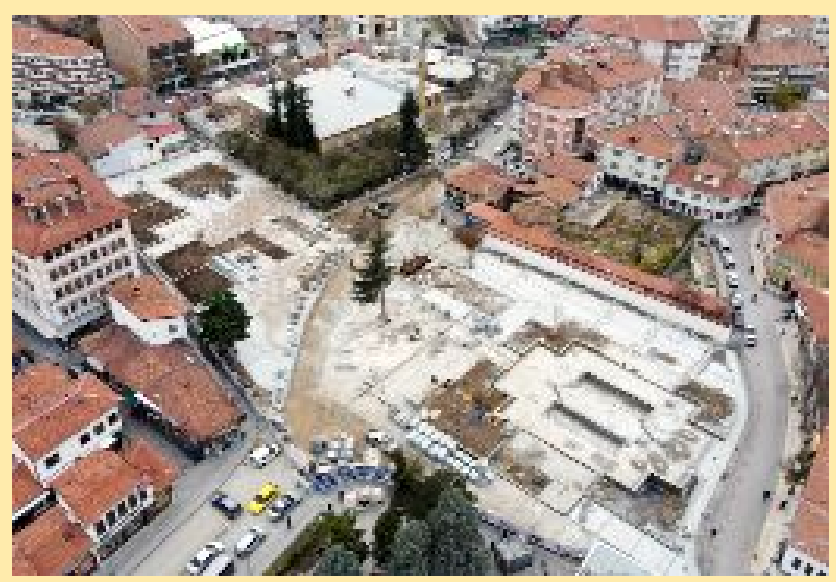
Çorum Belediyesi tarafından hayata geçirilen "Tarihî Çorum Meydanı" projesinde çalışmalar tüm hızıyla devam ediyor. Belediye Başkanı Aşgın çalışmalarda ilk etabın bu ay sonu bitirileceğini söyledi.
