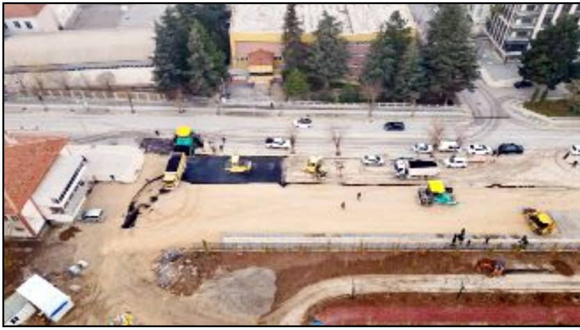
Hamit Kaplan Caddesi ve Bayındır 1. Sokak, 15 metre yol, 20 metre açık otopark alanı olarak düzenlendi.
