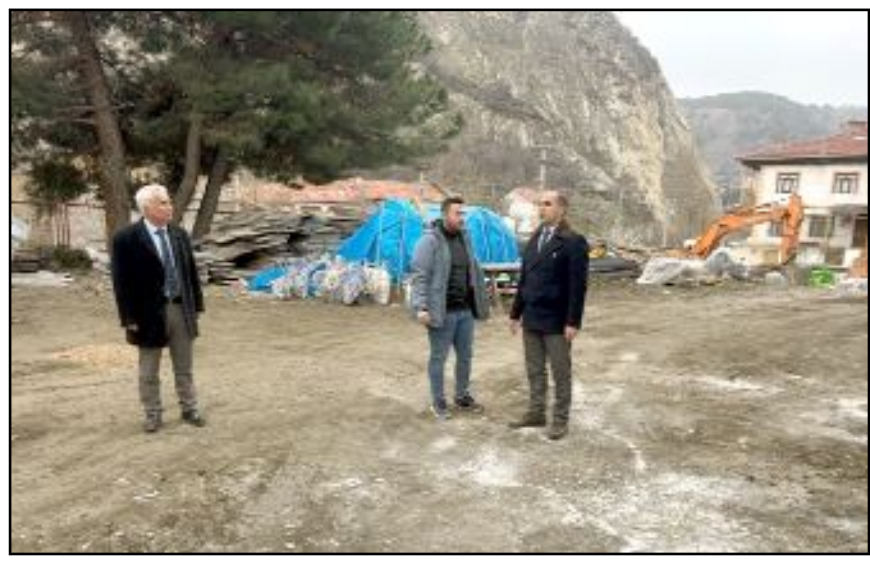
İskilip Kaymakamı Ramazan Polat, Ebussuud Efendi İlkokulu ve Ortaokulu'nun devam eden inşaatında incelemelerde bulundu.
