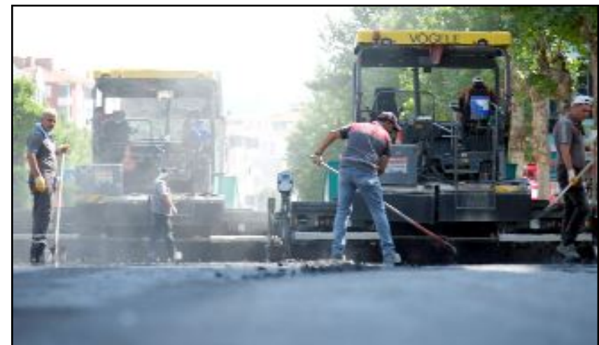
Adnan Özejder Caddesi'nde 270 metre uzunluk ve 10 metre genişliğinde kazı yapılırken, Hamit Kaplan Caddesi'nde de 280 metre uzunlukta 10 metre genişliğinde kazı yapılıyor.
