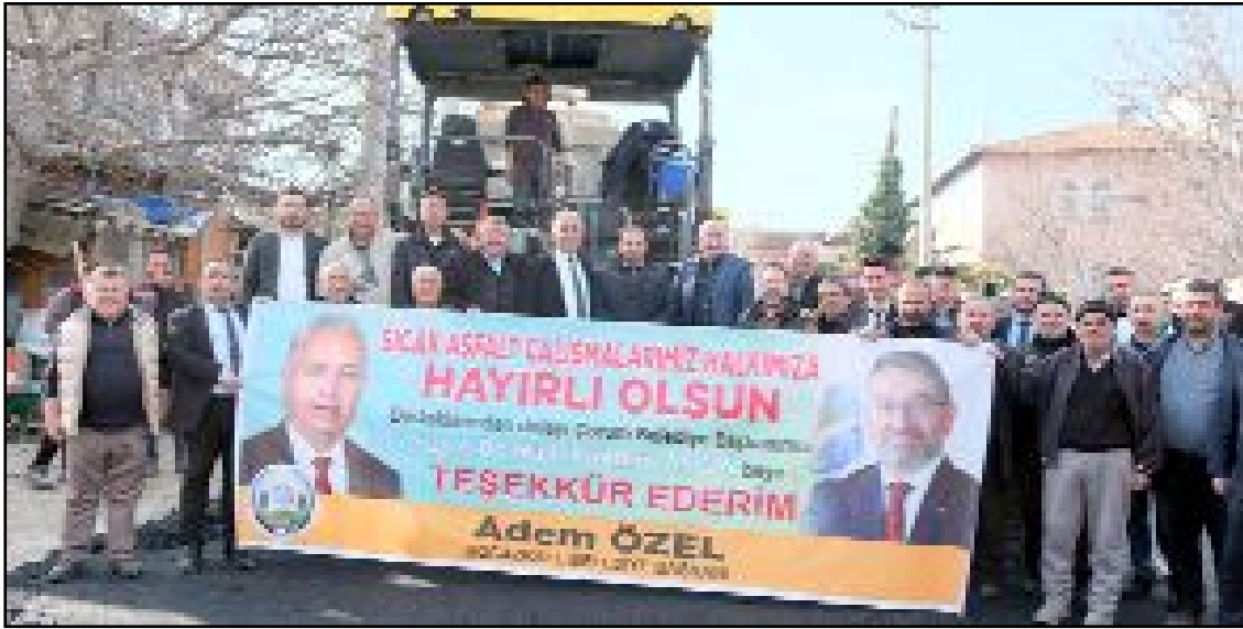
Çorum Belediyesi Fen İşleri Müdürlüğü ekipleri 500 metre uzunluğundaki Recep Tayyip Erdoğan Caddesi'ne bin ton asfalt serimi gerçekleştirdi.
