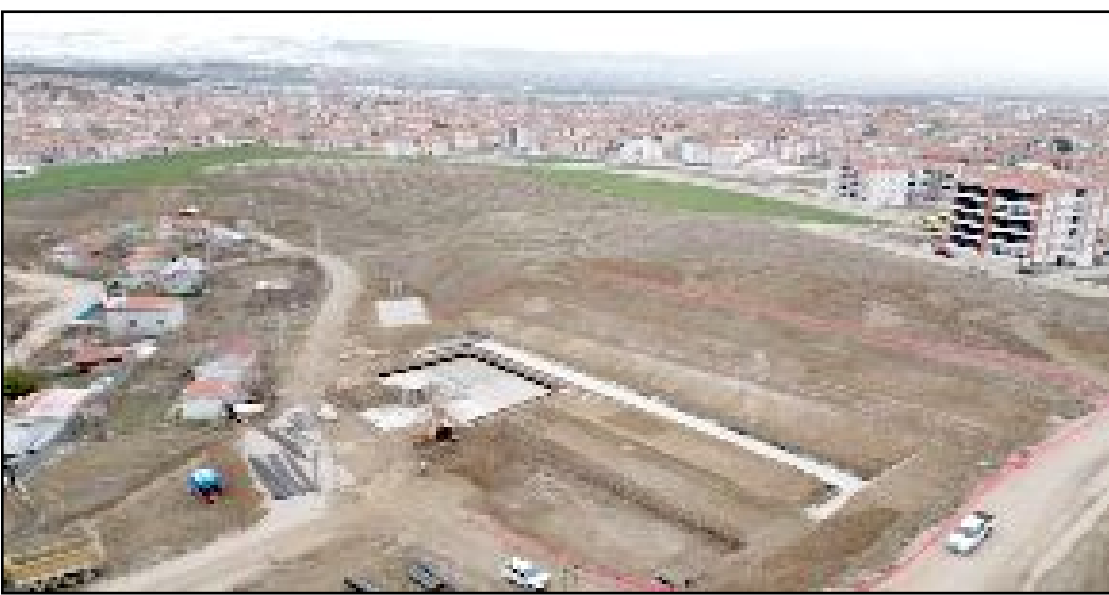
Kapaklı bölgesinde inşası başlayan İçme Suyu Terfi İstasyonu ile şehrin %80'lik kısmının su ihtiyacı karşılanacağı belirtildi.
