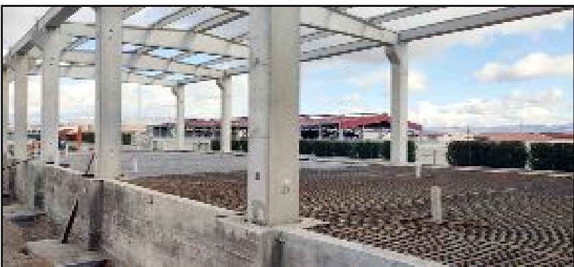
Yaş mama üretim tesisinde yıllık 1.000-2.000 ton atığın işlenerek yaklaşık 2.000 ton yaş mama üretilmesi planlanıyor.
