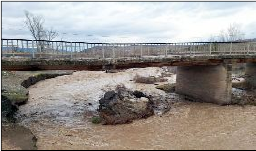
Yağışlar nedeni ile köprüünün 1950'de yapılan ayağı yıkıldı.
