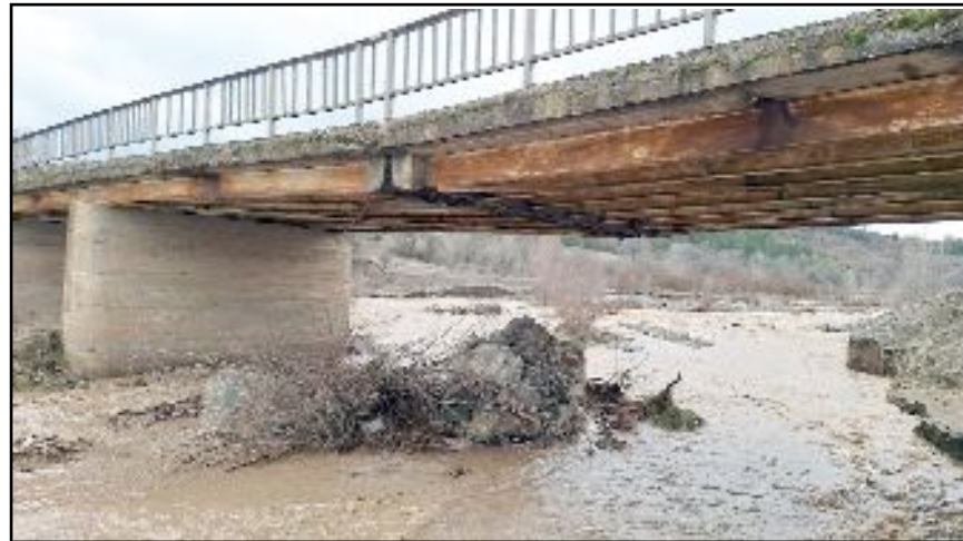
Çomu Çayı Köprüsü'nün bir ayağı yoğun yağışların ardından yıkılınca yol ulaşma kapanmıştı.
