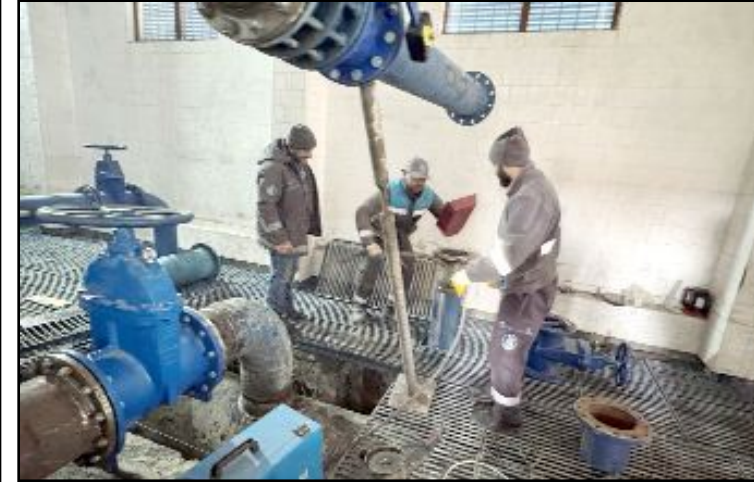
Eskice Pompa İstasyonu yenilenerek kapasite artırıldı, yeni kuyular ve kapasite artışıyla içme suyu arzı güvenceye alındı.
